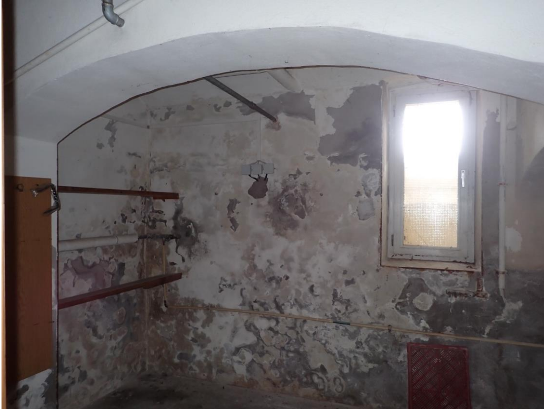
Abb. 10: Kellerräume sind als Lebensstätte nicht geeignet, da hermetisch verschlossen.
