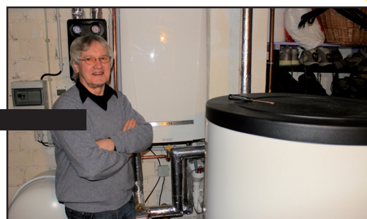
05 A12 Stromerzeugende Heizung - das Minikraftwerk im Heizungskeller Havelstraße 1 Ansprechpartner → Hans-Jürgen Kleinlein Fon 0 61 05 4 34 53
